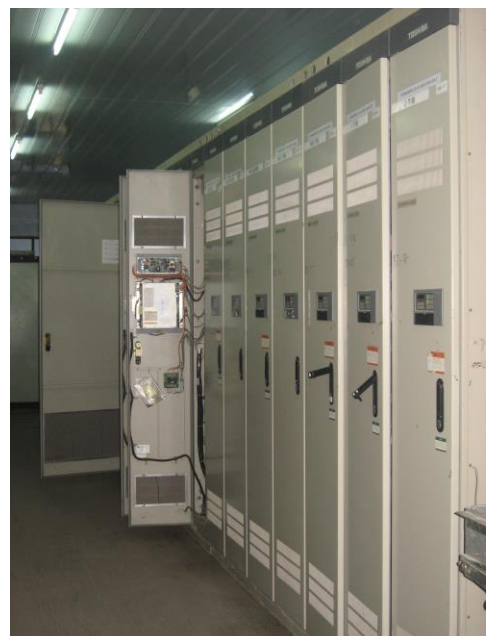
Hệ thống điều khiển nhà máy thép
