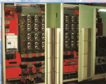
Tủ điều khiển động cơ DC 4500KW
